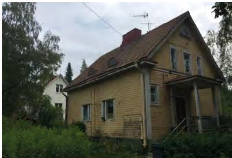
Peruskorjausta vaativassa kunnossa oleva talo vuodelta 1925, Sudenkatu 37.
